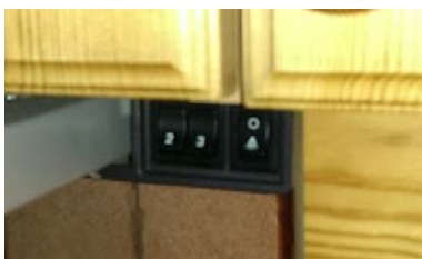
Brytere, avtrekksvifte kjøkken.
